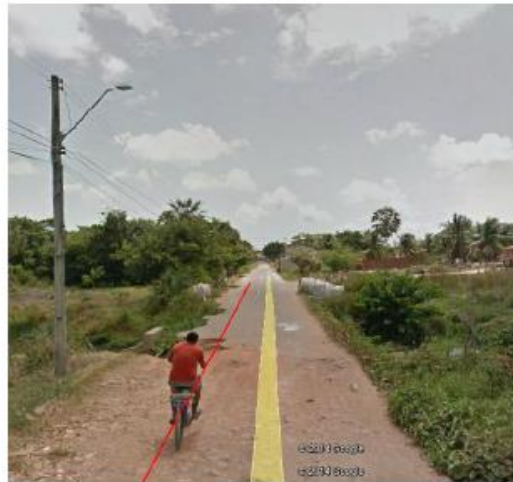
Figura 2 – Vista do local da obra com trecho danificado.
